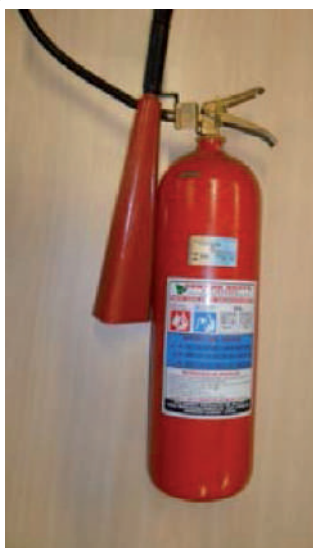
Figura 3 – Extintor Gás Carbônico
